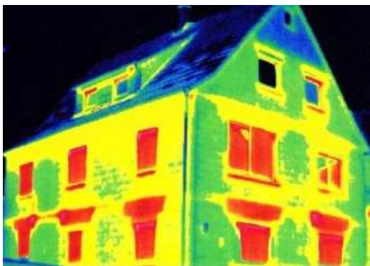
la termografia mette in evidenza la grande perdita di temperatura (superficie rossa) in corrispondenza dei cassonetti non coibentati al piano inferiore
