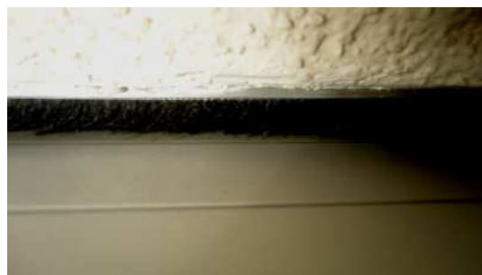
fessura tra avvolgibile e telo all'esterno dopo l'applicazione dello spazzolino
