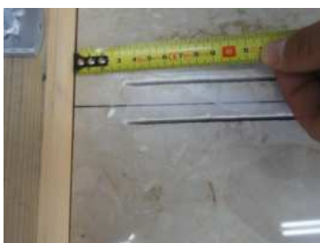
Arrivati al bordo rimangono 3 cm che non possono essere tagliati: sui lati rimarranno quindi due ponti termici puntuali
