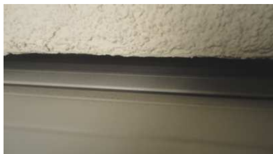
fessura tra avvolgibile e telo all'esterno prima dell'applicazione dello spazzolino
