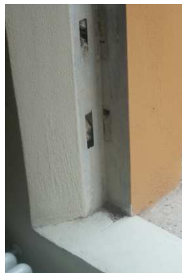
Il marmo passante è un ponte termico che ancora si vede anche nelle nuove costruzioni
