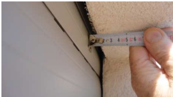
Lo Spazio tra l'avvolgibile ed il muro esterno in questo caso è di 1,5 cm
