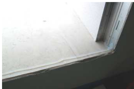
Il marmo passante è un ponte termico che spesso viene realizzato anche nelle case nuove
